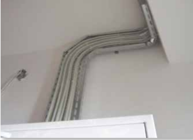
Kablolar bina içerisinde tek bir kanala döşenirler.
