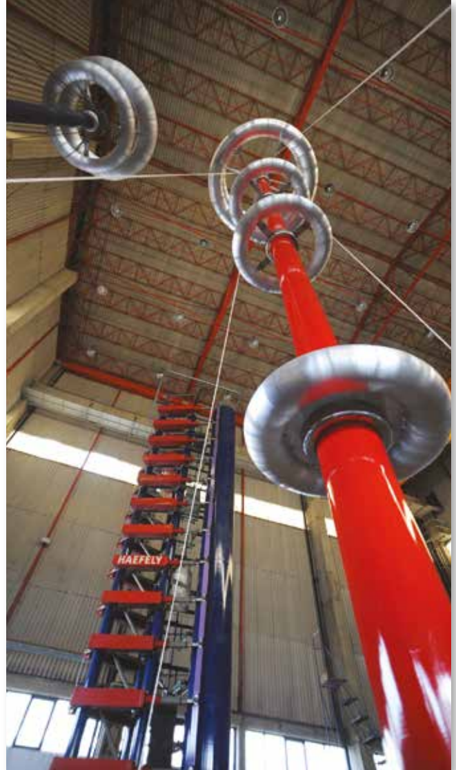
Yıldırım darbe jeneratörü gerilim bölücü.
